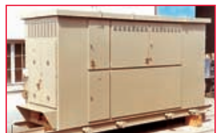
Mine, Togo, poste mobile 5,5 kV/380V
