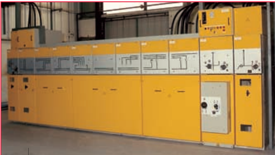
Intégration d'ensemble : autotransformateurs, disjoncteur, contacteur
