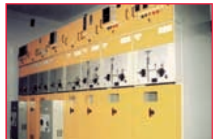
Arrivée disjoncteur et départs contacteurs
